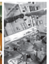
Quadro di comando
