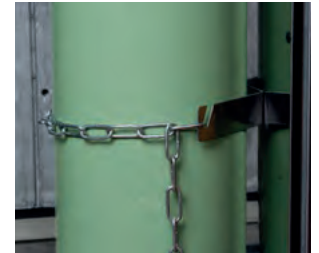
Bouteille de gaz sécurisée
